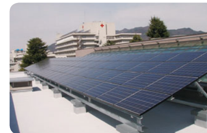
長野市保健所屋上にある太陽光発電システム
