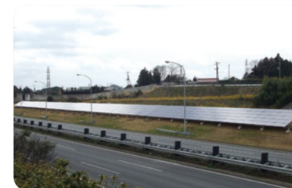
車道脇に設置された太陽光パネル
