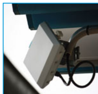
各コーナーポストの外壁や支柱に無線アンテナを設置
