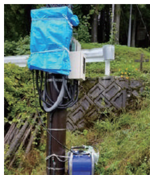
停電基地局に取り付けた 発電発電機(NDS)
