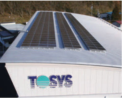
TOSYS本社綿内ビルに並ぶ太陽光パネル
