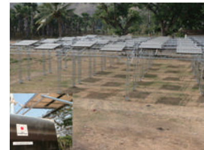
設置スペースを農地利用できるように 配慮して設置した太陽光パネル(サンコム)
