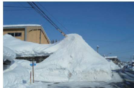
雪に埋もれたケーブル
