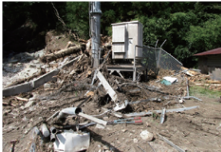
鬼怒川上流基地局被災状況
