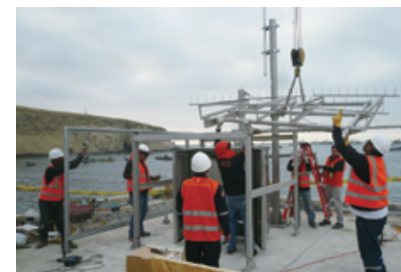
潮位計の設置
