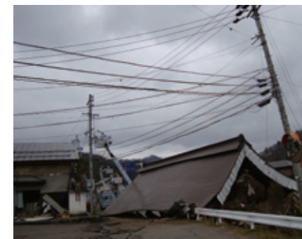
地震により激しく傾く電柱
