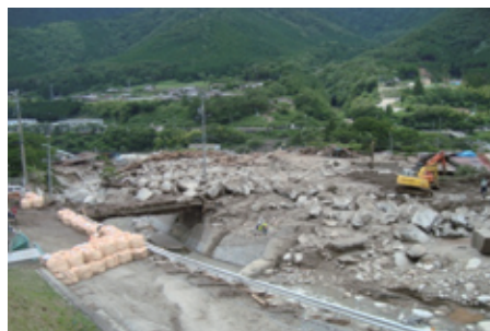
大規模な土石流で被害を受けた読書地区（梨子沢）
