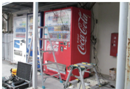
田の原山荘食堂に緊急回線を設置
