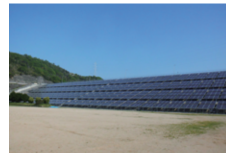
太陽光発電設備が設置された権現ダムの堤体
