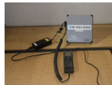
避難所に設置した衛星公衆電話
