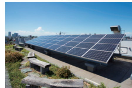
世田谷TSの屋根に並ぶ太陽光パネル
