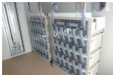
基地局内のバッテリー
