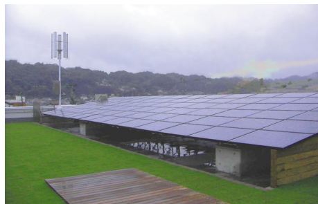
△ 学校施設における風車+太陽光+屋上緑化システム
