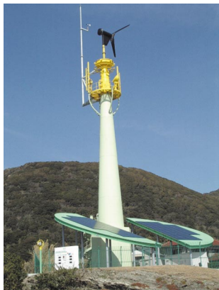
◁FOMA基地局 「DoCoMoエコタワー」
