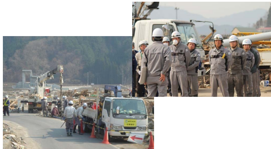
家屋約3,000棟が倒壊、800名以上の死者・行方不明者を出した岩手県山田町での復旧作業
