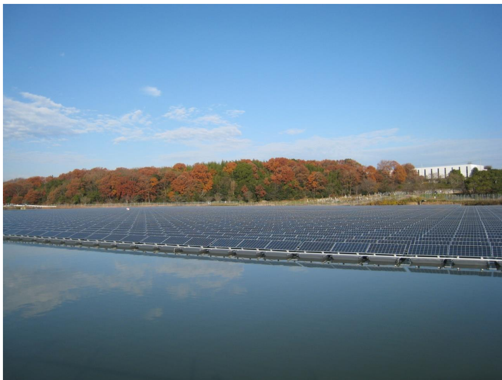
水面に浮かぶ太陽光パネル
